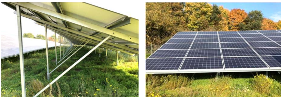
Abbildung 6: Beispiele für Module einer Photovoltaik-Freiflächenanlage des selben Vorhabenträgers in Emkendorf (Quelle: SolarWind Projekt GmbH, Hamburg)
