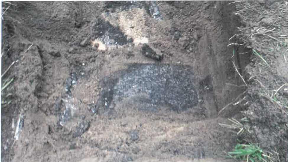
Foto 2: Schurf S 3 mit Straßenaufbruch und Bauschutt
