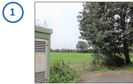
Solarpark nicht einsehbar
