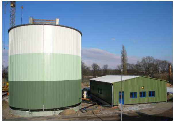
Abbildung 31: Klärschlammfaulung des Technischen Betriebszentrums
