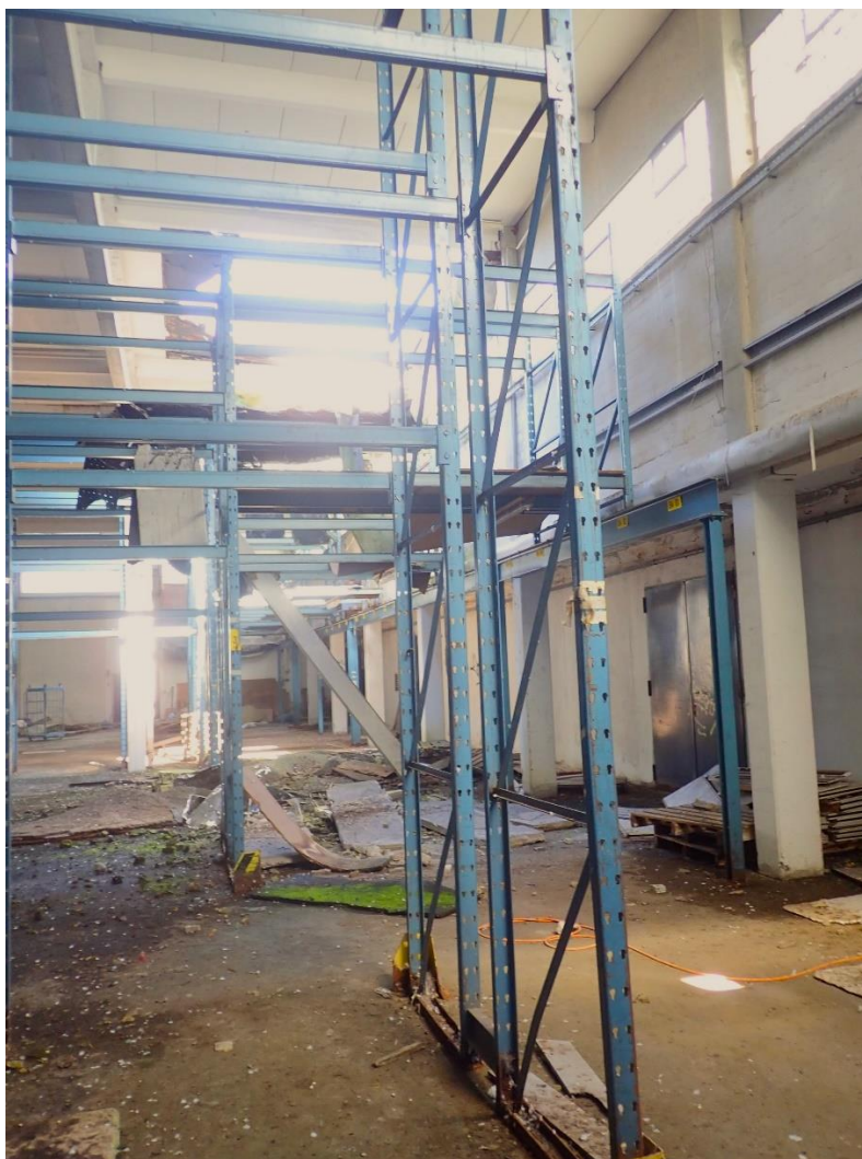
Abbildung 9: Teilbereich der Lagerhalle mit Blick auf ein Loch im Dach. Foto: Elbberg 2023.
